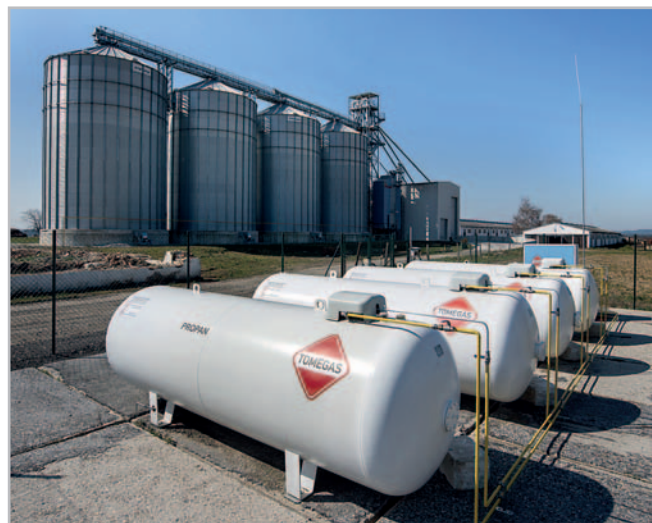
Čtyři zásobníky kapalného propanu jsou připraveny pro provoz sušičky Foto archiv firmy
