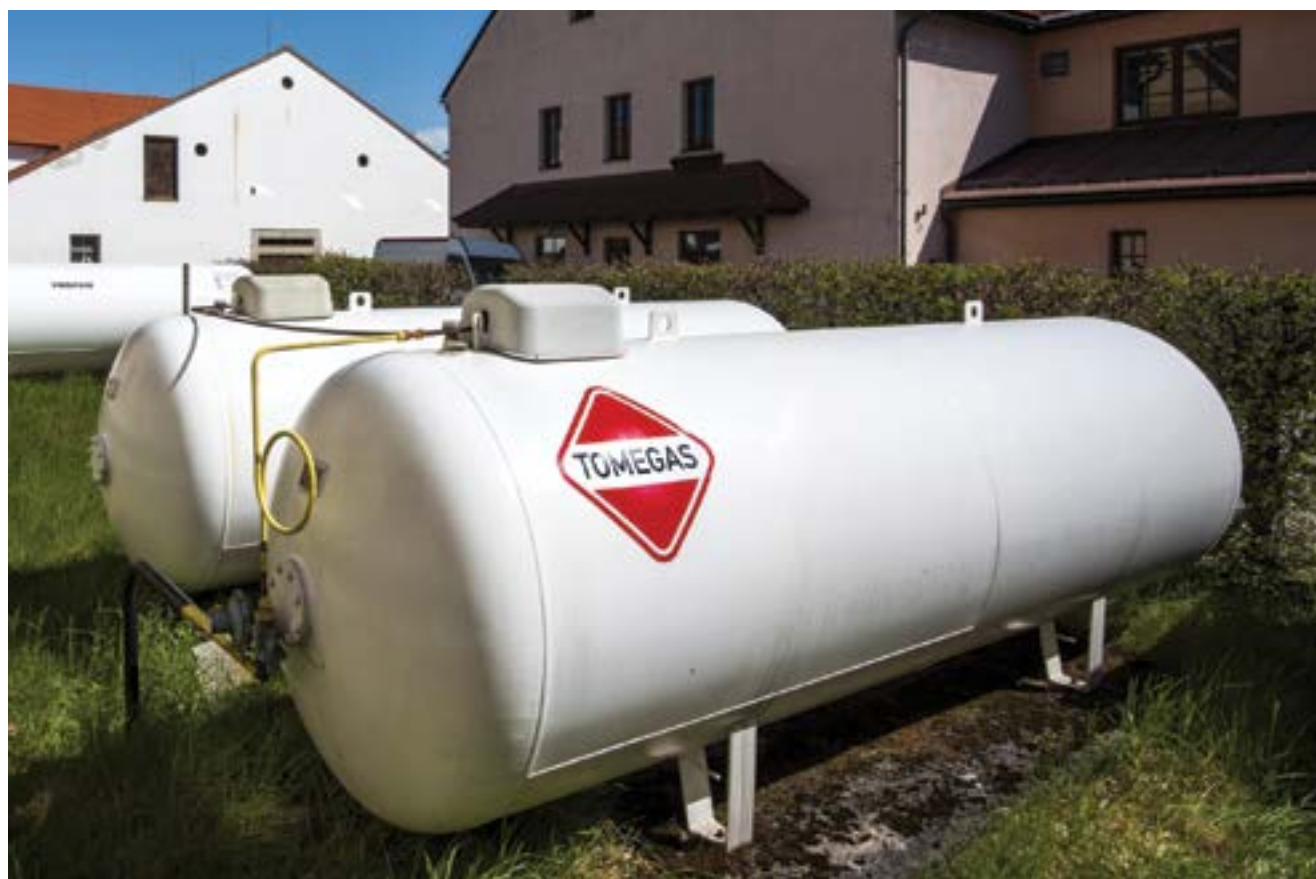
Propanem je vytápěn obecní úřad i sousední budova se 14 byty, lékařskou ordinací a knihovnou.
