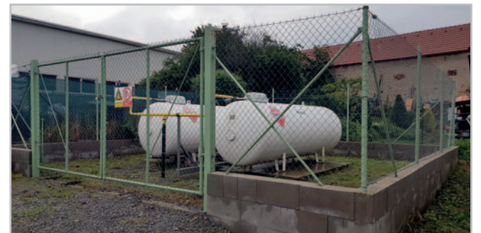
Zásobníky kapalného propanu (LPG) jsou naprosto bezpečné Foto archiv firmy
