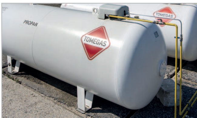
Velikosti zásobníků jsou od 2,7 do 250 m 3 Foto archiv firmy
